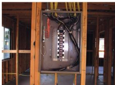
(E) INTERIOR PANEL (SUBPANEL)
